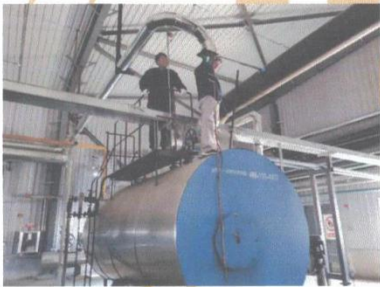
4t 天然气锅炉采样
